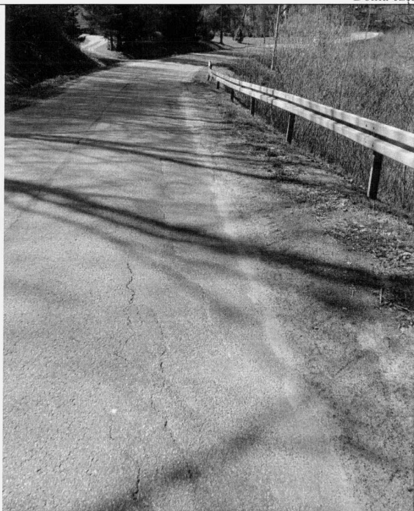
Podłużne pęknięcia drogi powiatowej
